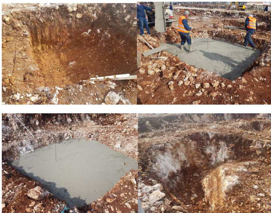
Slika 11. Primjer pripreme temeljne podloge u okršenoj stijenskoj masi (čišćenje zona ispunjenih glinom i zamjena sa štednim betonom).
